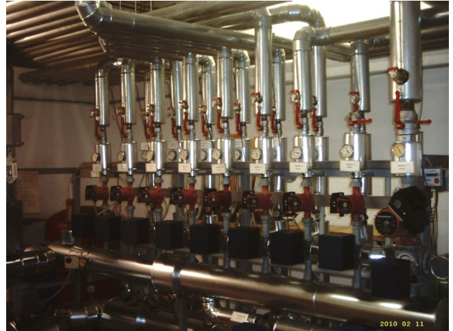
Abbildung 5: Verteilerstation (von GA gere- gelt)
