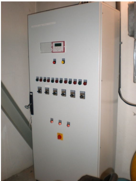
Abbildung 2: Schaltschrank für GA von außen
